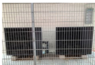
Abb. 67: Zwei Außeneinheiten der Wärmepumpe
