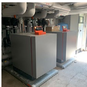
Abb. 52: Wärmepumpen im Keller
