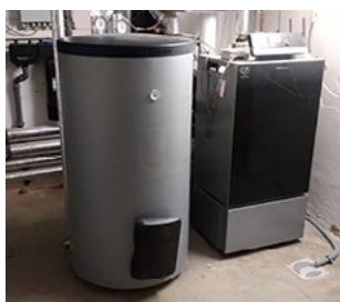
Abb. 37: Speicher und Wärmepumpengerät
