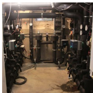
Abb. 53: Hydraulik der Quell-Erschließung im Keller
