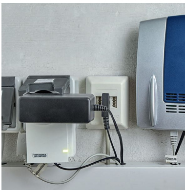
SPD Typ 3 zum Kombischutz der 230 V- und der Telefonleitung vor dem Router (Ausführung als Zwischenstecker)
