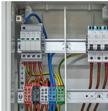
SPD Typ 2 im Zählerschrank eines Gebäudes ohne äußeren Blitzschutz
